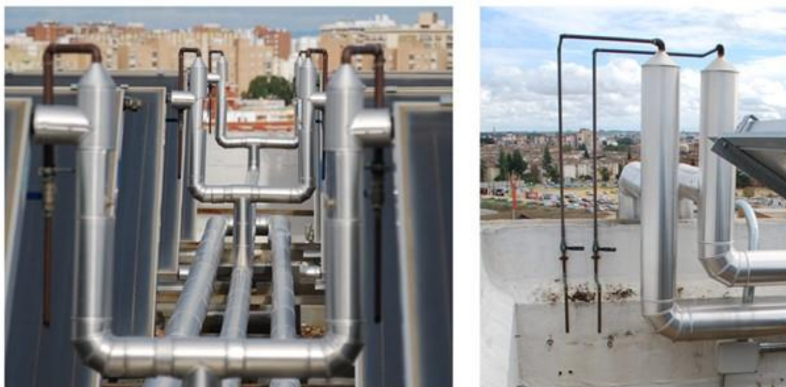
Figura 1: Ejemplos de circuitos primarios con purgadores manuales que mejoran la estanqueidad y facilitan las labores de mantenimiento
