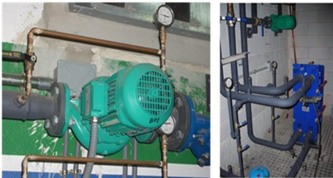
Figura 85: Puentes manométricos para medida de presión diferencial en bomba (izq.) e intercambiador (der.)
