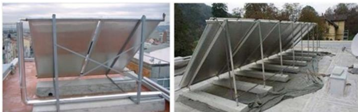
Figura 54: Ejemplos de bloques de hormigón como base de reparto y contrapeso de la estructura soporte de captadores
