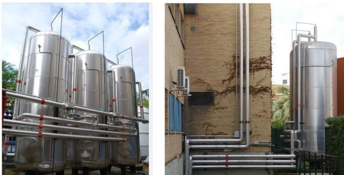
Figura 98: Montaje de acumuladores solares en el exterior y los circuitos hidráulicos que los conectan
