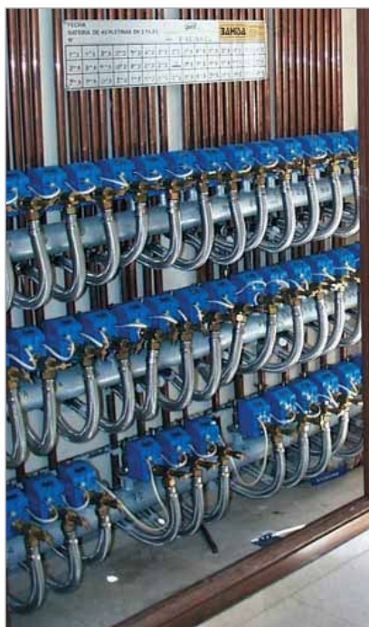
Batería de Contadores individuales
